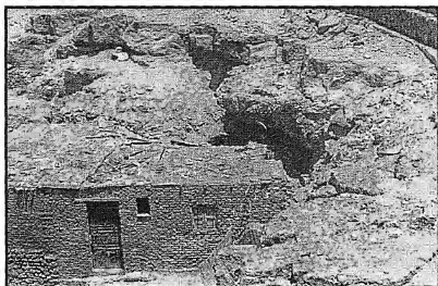
صورة (٥٨) : أحد المباني الصغيرة بمنشأة ناصر، وتعلوه كتلة صخرية ضخمة تمثل خطراً عليه إذا ما انهارت فوقه فجأة.
